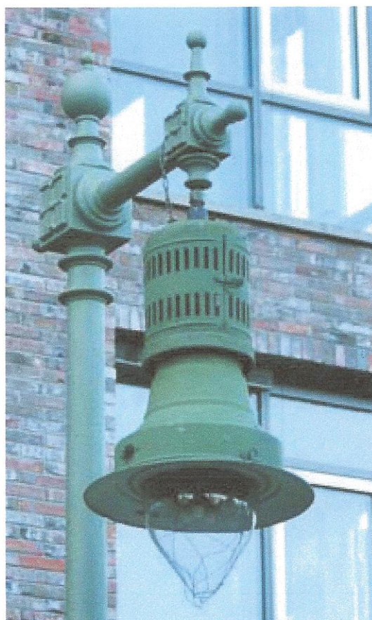
B-Tiergarten, Gas-Hängeleuchte an einem Guss- Galgenmast, Neuanlage ca. 1995
